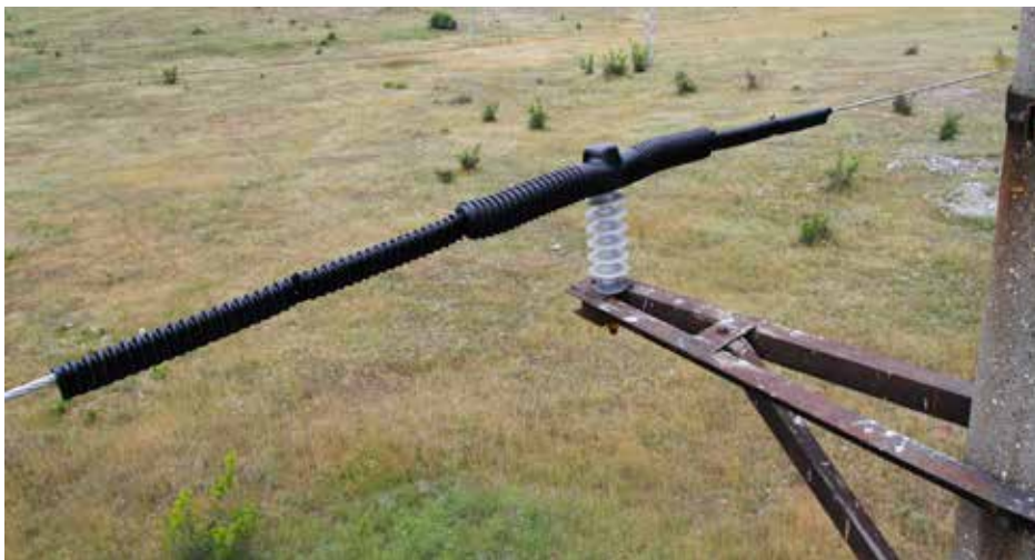
Снимка 27: Стоманобетонен стълб от тип 2 с монтирани изолационни покрития с удължители в Натура 2000 зона „Сакар“
