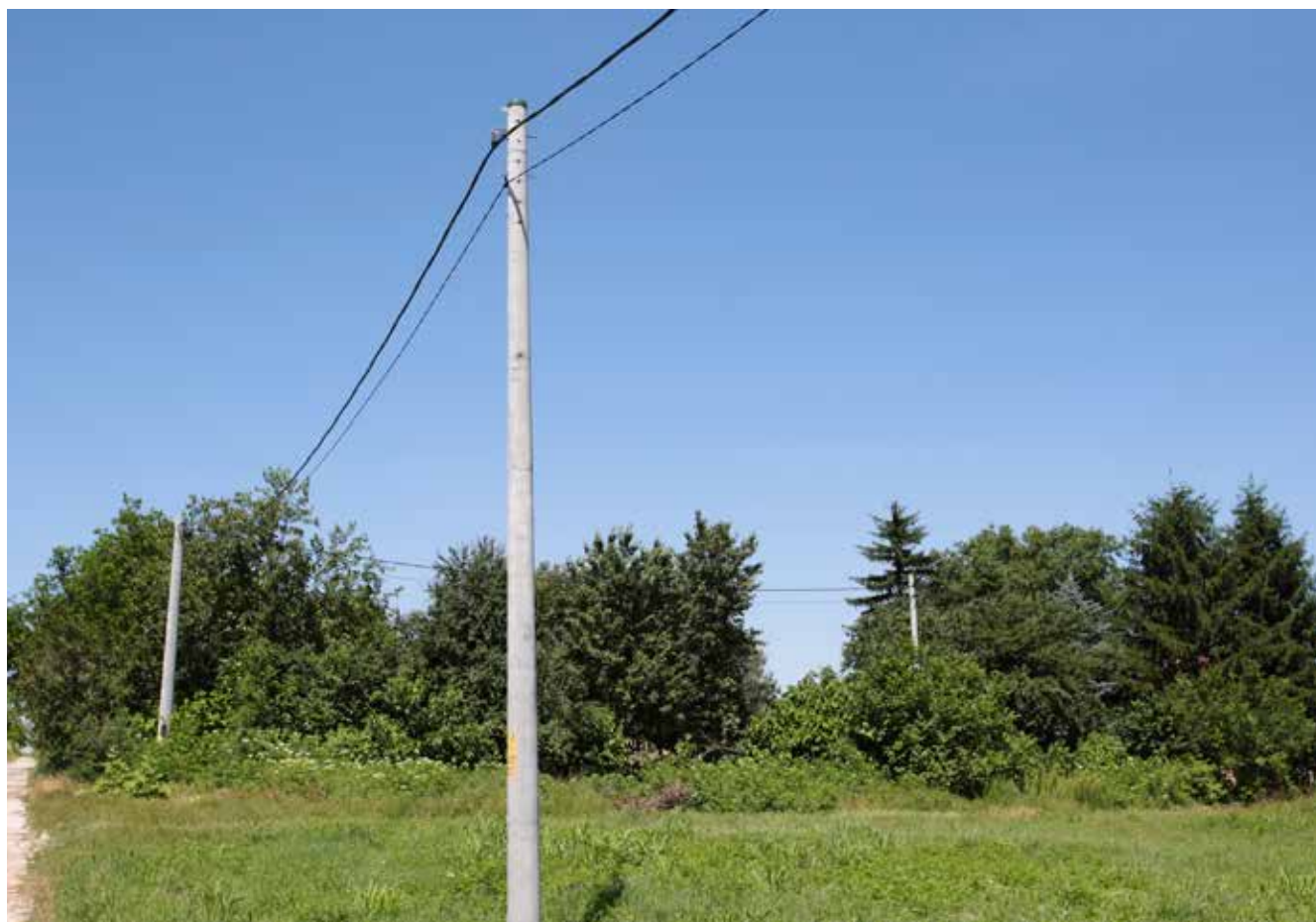
Снимка 18: Въздушна кабелна електропроводна линия за ниско напрежение
