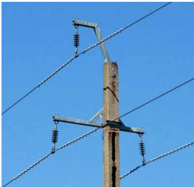
Снимка 12: Унгарска конзола с висящи изолатори тип PÖYRY Erőterv Zrt. TfbH
